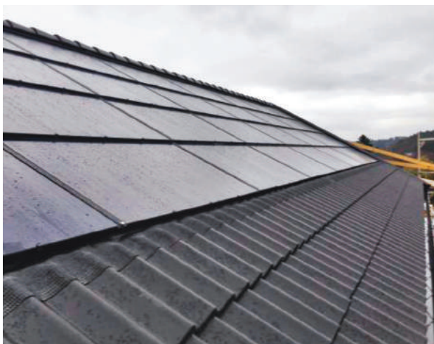
Figur 6.4 Bygningsintegrerte solcelle-paneler på taket til ZEB pilotbygg Skarpnes, Arendal. Foto: Skanska.
